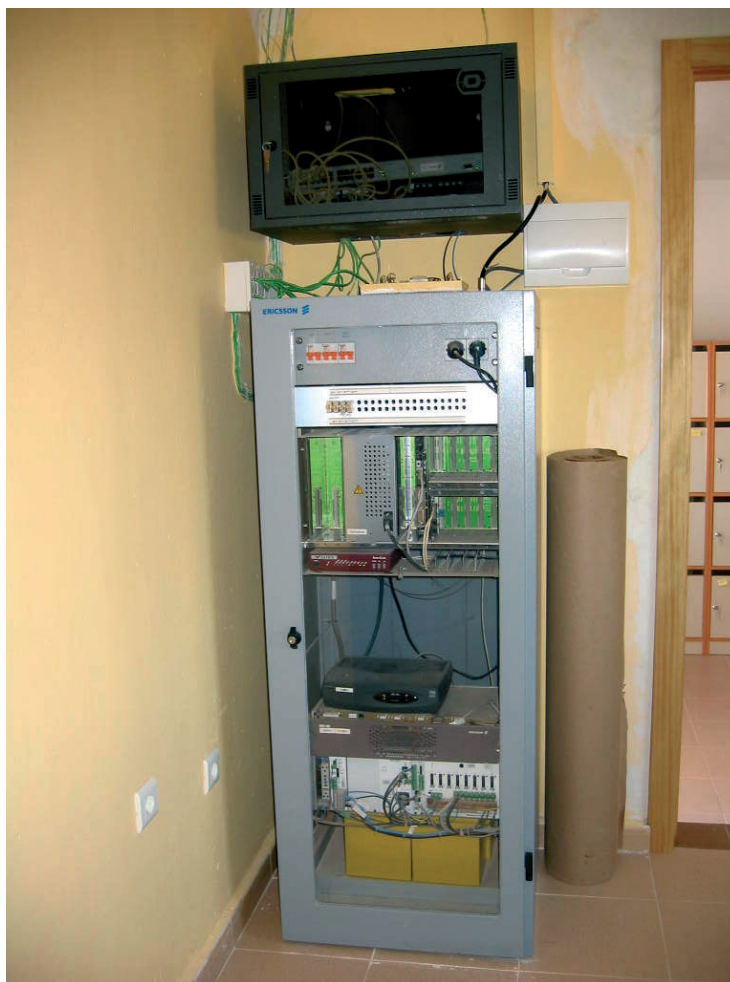
Fig. 5. Armario del registro principal de telefonía y redes de un centro deportivo
